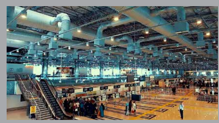
TRABZON HAVALİMANI Havalandırma - Isıtma - Soğutma
