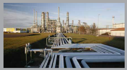
BAKÜ-TİFLİS-CEYHAN BORU HATTI Terminal Binaları Isıtma-Soğutma-Havalandırma
